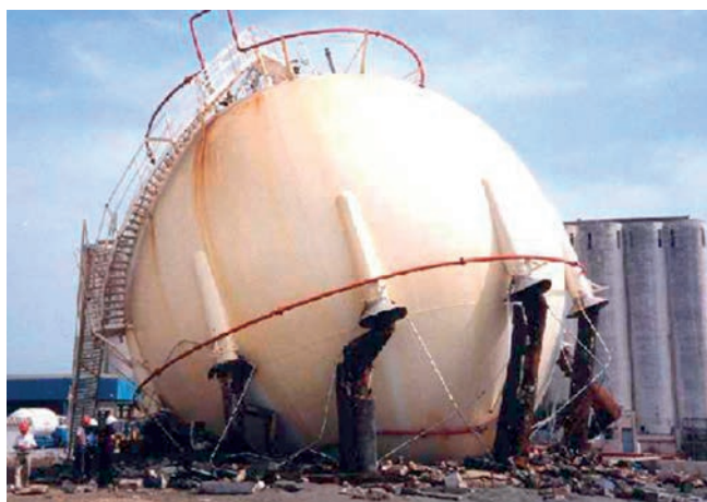
Následky koroze pod cementovou protipožární ochranou.
