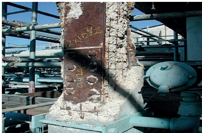
Koroze pod cementovou vrstvou
